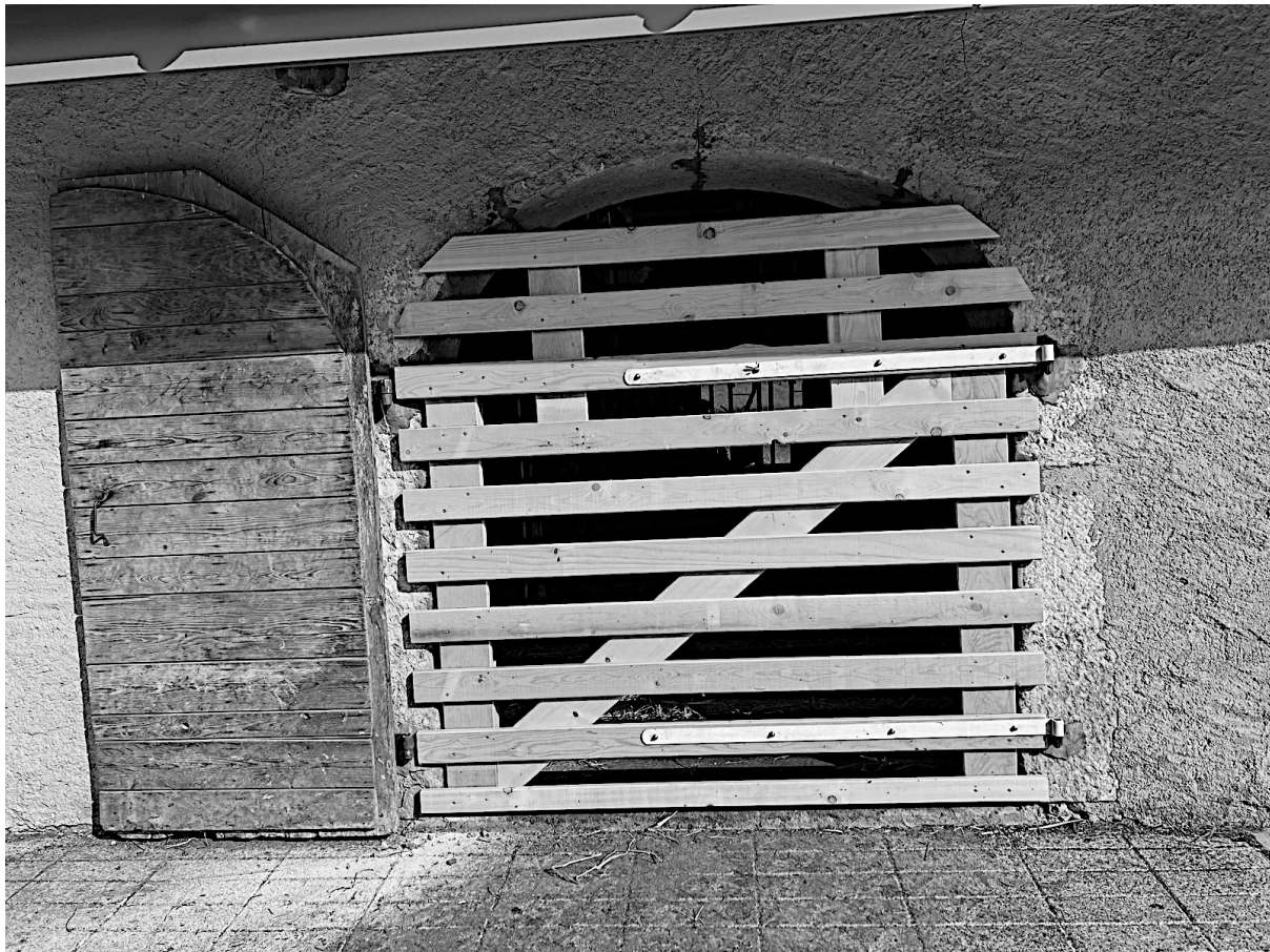
Porte de l'étable du chalet des Begnines permettant d'éviter toutes pénétrations par des prédateurs tout en laissant l'air circuler. La porte faisant face de l'autre côté du bâtiment a également été adaptée.
